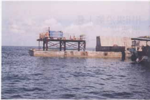
H16災沿第1号 消波堤 ケーソンワイヤーソー切断 作業架台設置
